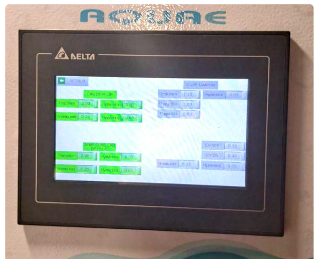
Ecran de paramétrage de niveau de protection des pompes pour chaque cuves de stockage et cuve tampon skid.
