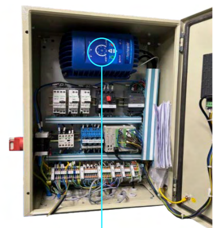
Variateur de vitesse alimentant la pompe de transfert
