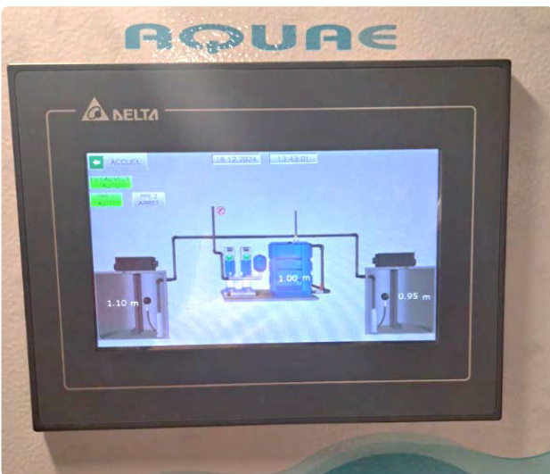
Ecran représentant l'installation avec indication de niveau pour chaque cuves de stockage
